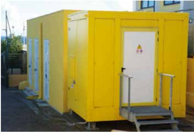
Figura 6.2- Foto del sistema di accumulo integrato nella centrale Enel di Ventotene.
