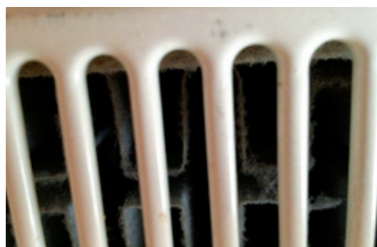
Figura 4.12: Stato di pulizia dei radiatori
