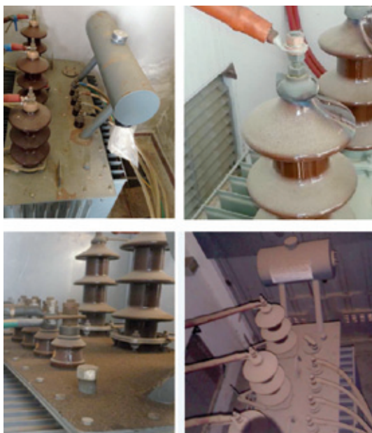
Figura 4.7: Condizioni di pulizia degli isolatori
