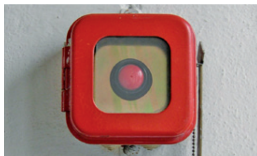
Figura 1.8: Pulsante di sgancio per apertura DG cabina
