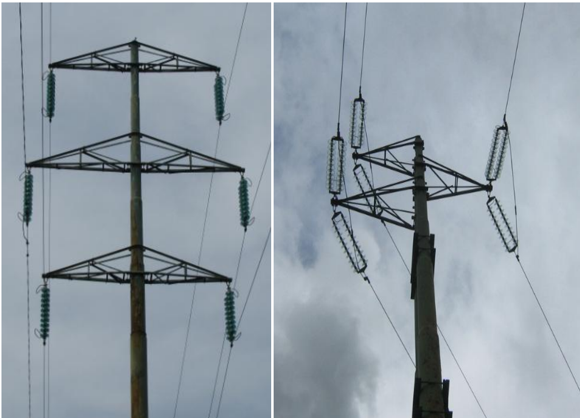
Figura 1a: Armamenti con mensola tralicciata in sospensione ad "I" (foto a sinistra) e in amarro (foto a destra)
