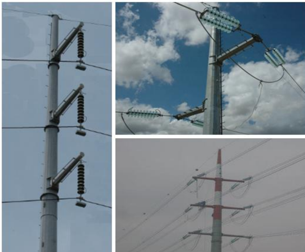
Figura 1c: Armamenti con mensola scatolare in sospensione ad "I" (foto a sinistra), in amarro conduttore singolo (foto in alto a destra) e in amarro conduttori a fascio (foto a destra in basso)
