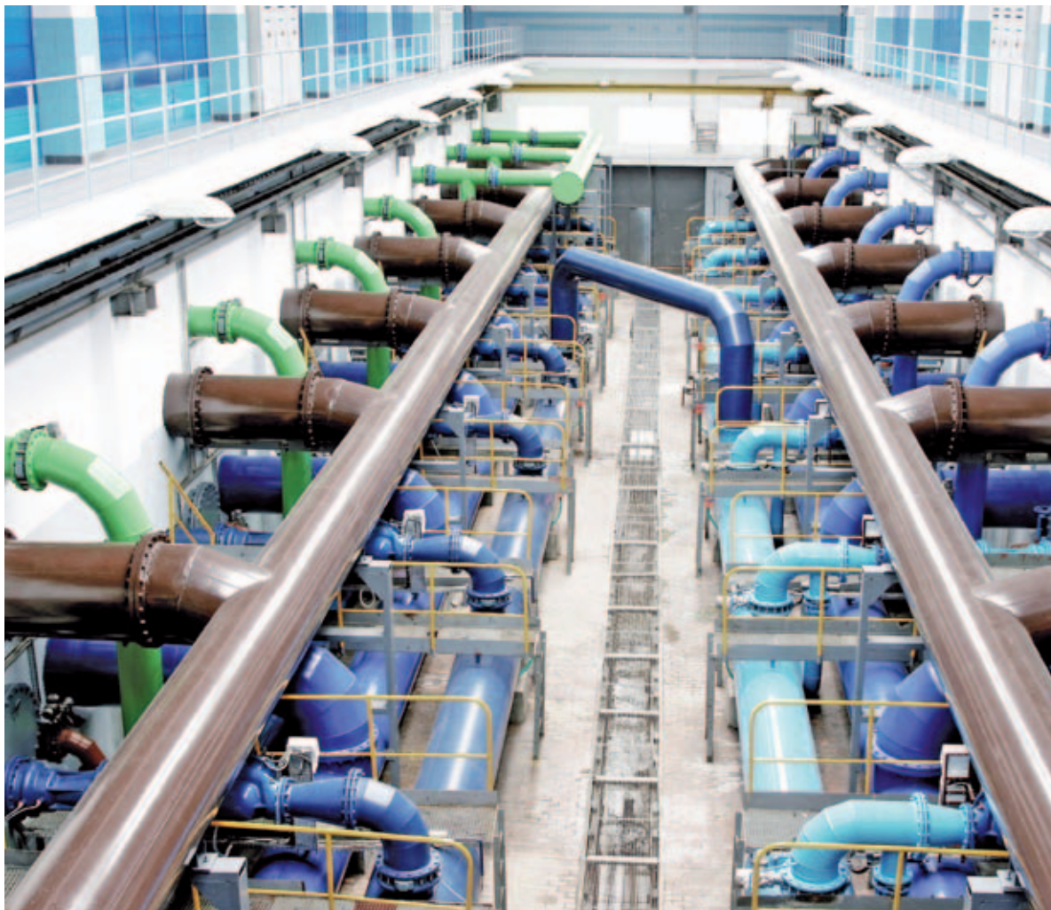
Figura 21. Funzioni di controllo pompe intelligenti per il potenziamento dell'efficienza energetica
